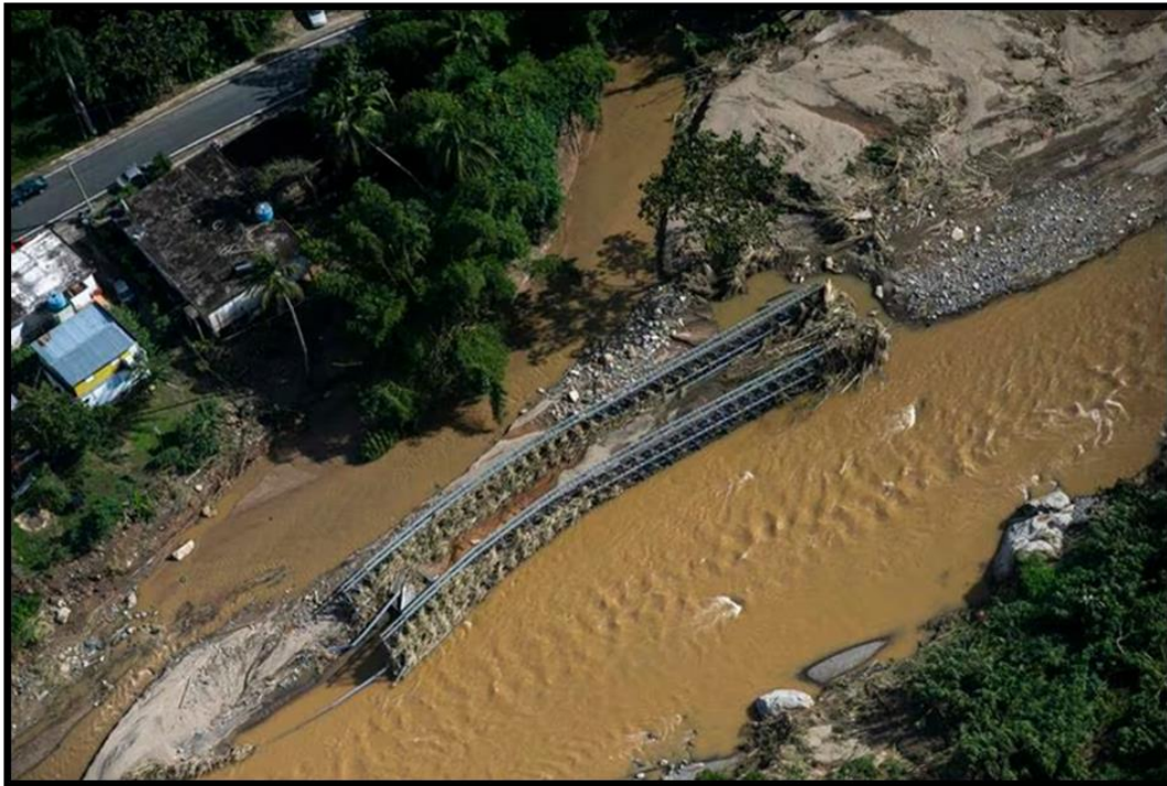
Figura 30: Daños de Infraestructura en el Municipio de Utuado. El Nuevo Día, 22 de septiembre de 2022.
