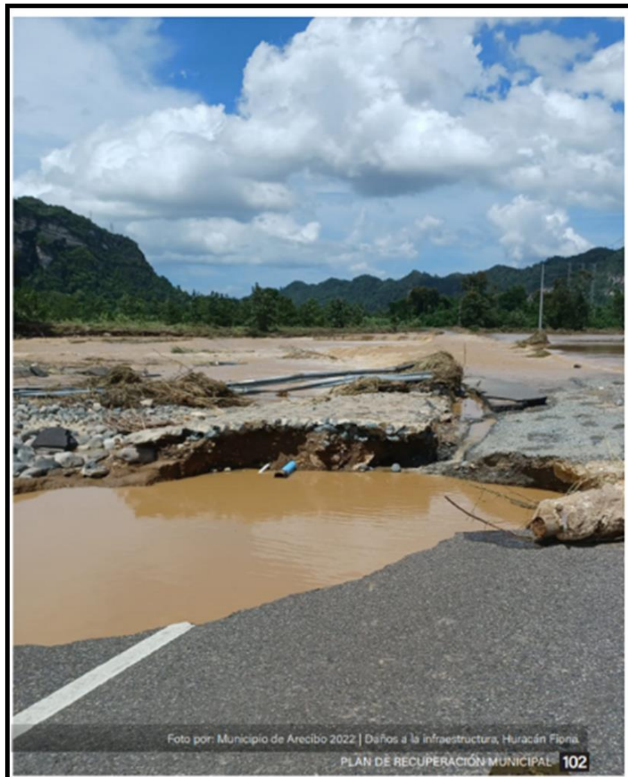
Figura 27: Daños viales cerca del sector Jurutungo y el Río Grande en el municipio de Arecibo. Plan MRP Municipio de Arecibo.
